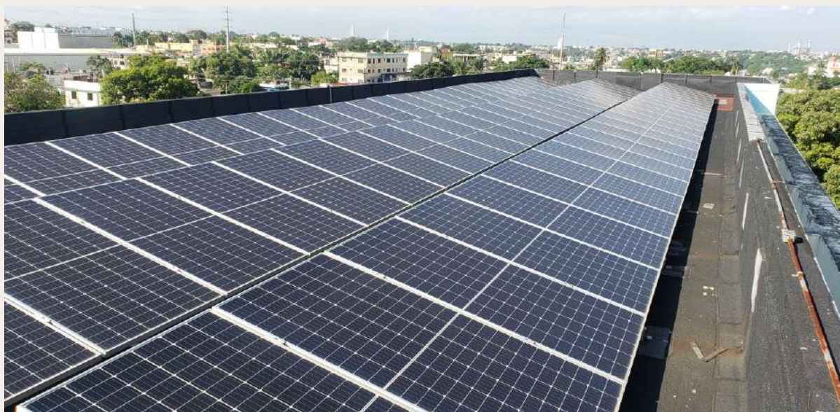
Planta fotovoltaica instalada en el ISPFB.
